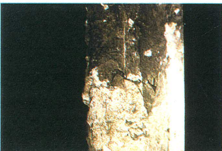
19. Desmoronamiento. Claustro de la catedral de Burgos
