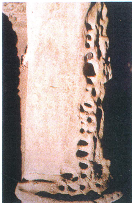
21. Alveolización. Palacio de Revillagigedo (Gijón)
