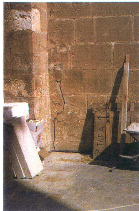
22. Fisuras. Catedral de Palma de Mallorca
