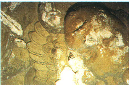
20. Eflorescencias. Catedral de Murcia
