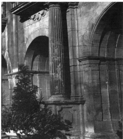
Fig. 8. Descamaciones y desplazaciones en una columna de la entrada.
