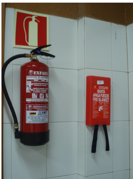
Figura 5. Extintor portátil de polvo polivalente y manta anti-incendio.
