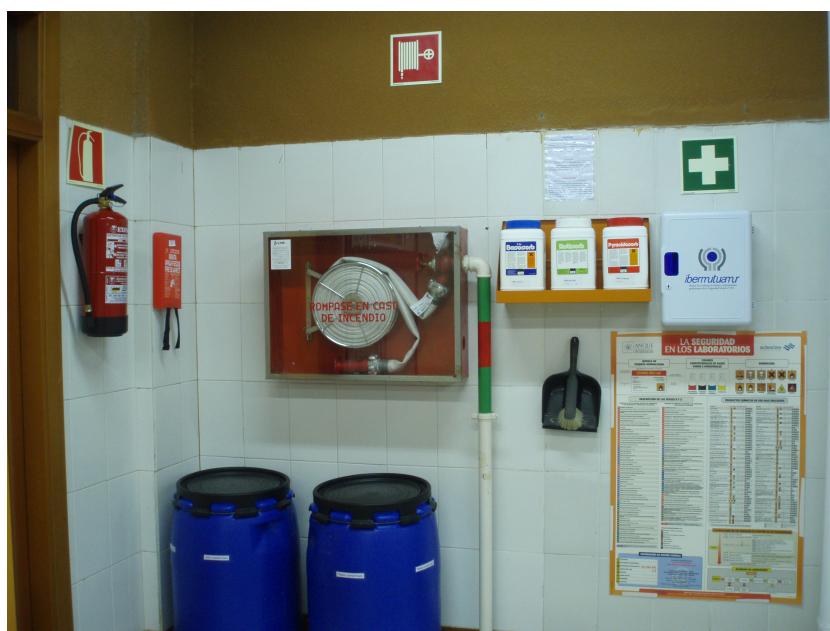
Figura 1. Equipamiento general de seguridad. Todos los equipos están convenientemente señalizados.
