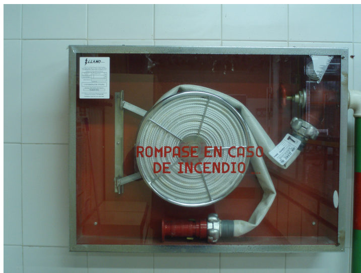
Figura 6. Boca de incendios equipada con una manguera extensible de 45 mm de diámetro.
