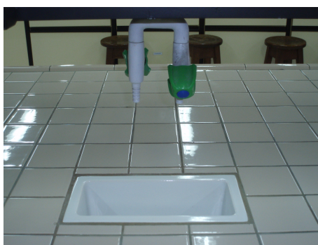
Figura 1. Grifos para agua (y pileta de desagüe) ubicados en la mesa de trabajo experimental de gres.
