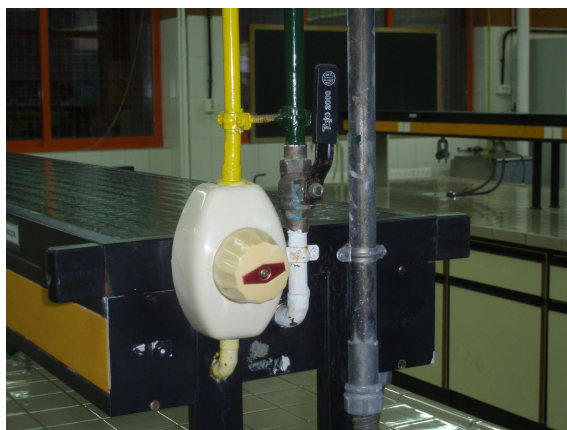
Figura 4. Llaves de paso para agua (abierta) y gas natural (cerrada). Obsérvese el color verde para la tubería que conduce el agua y el color amarillo para la que conduce el gas natural.
